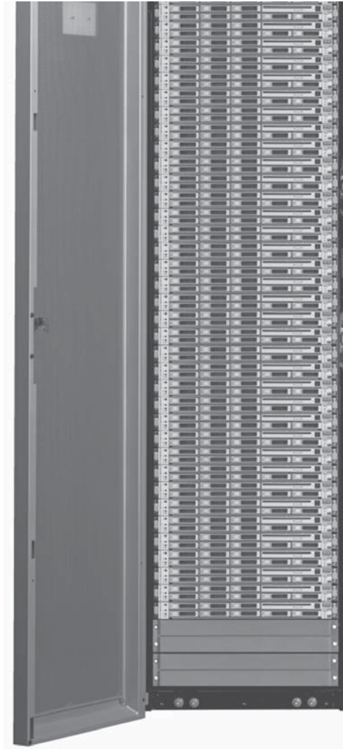
FIGURA 6.15 Armario estándar de 19 pulgadas ocupado por 42 servidores 1U. Este armario tiene 42 servidores 1 U “caja de pizza”.
